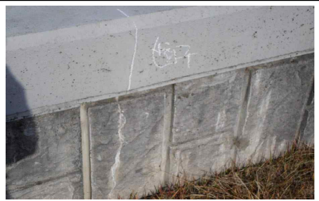
산화구 균열 백태
