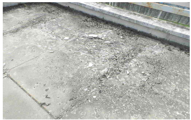
유입펌프장 옥상마감 표면박리
