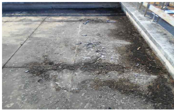
유입펌프장 옥상마감 표면박리
